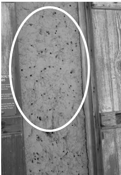
1-(3)-③-1b 蜂による土壁の被害（穴）
